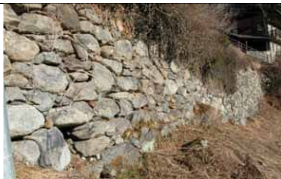
Vecchio muro di contenimento del terreno, realizzato con tecnica a secco (muro drenante) con pietre del luogo (gneiss)
