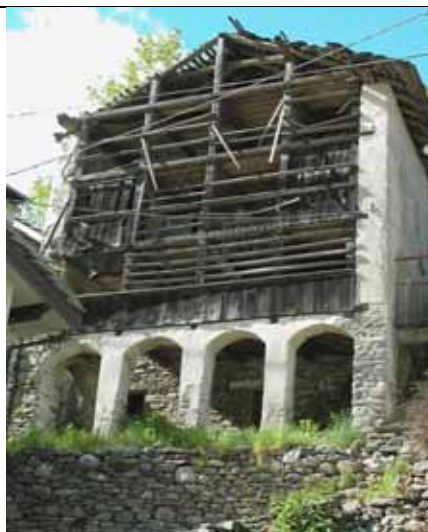
Casa in pessime condizioni con loggiato ligneo retto da porticato ad archi su pilastri in muratura intonacata - fraz. Pie' di Fagiolo (foto 2003)
