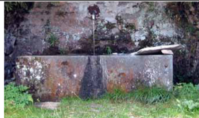
L'ambiente umido ha favorito il degrado delle superfici lapidee, che risultano completamente coperte da incrostazioni, efflorescenze saline, impianto di muschio e licheni, depositi di ossidi – Boccioleto, fraz. Palancato
