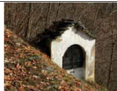
Il terreno addossato e l'accumulo di fogliame e di neve in inverno provocano un dannoso ristagno di umidità - Sabbia, fraz. Massera
