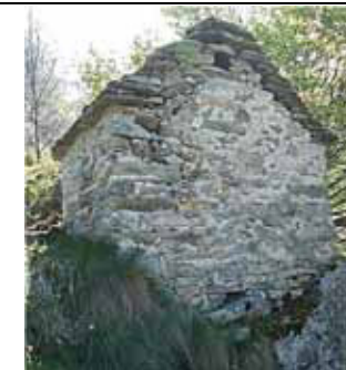
Discontinuità della struttura muraria dovuta a cedimento differenziale della fondazione - Rimasco, fraz. Dorca
