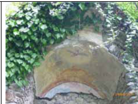
Unico frammento di intonaco rimasto nella cappelletta della foto a sinistra. Si notano i danni provocati dall'edera che con le radici penetra nelle fessure dell'intonaco, facendolo staccare e cadere e s'insinua tra le pietre, smuovendole - Guardabosone
