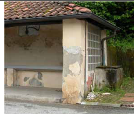
Diffuso degrado degli intonaci interni ed esterni
