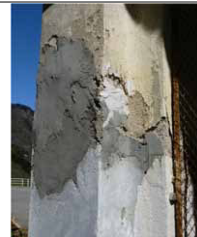
Rappezzi d'intonaco eseguiti in maniera grossolana e con impiego di malta cementizia - Cervatto, Via Crucis (foto 4-2015)
