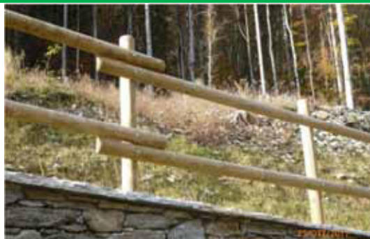
Montanti a sezione circolare e traverse a mezzo legno, fissate esternamente ai pali. Legno di conifera pre-trattato e lavorato in stabilimento; sullo sfondo: bosco di larici - Riva Valdobbia
