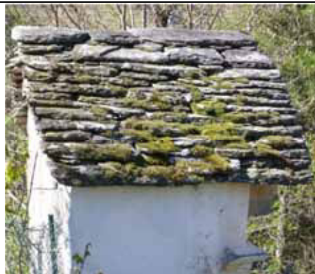
Tetti in cattive condizioni, con piode scivolate e smosse dalla propria sede, crescita di muschio - Cervatto, Via Crucis (foto 4-2015)
