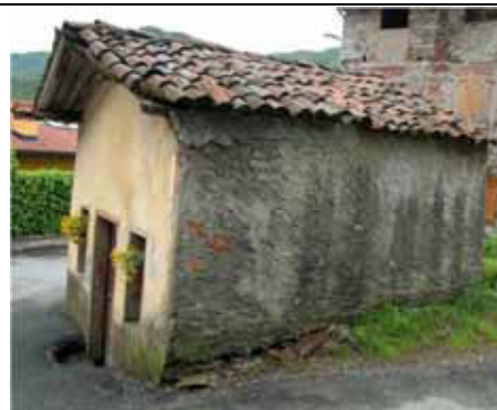
Condizioni di degrado generalizzato, riguardante copertura in coppi, intonaci e murature, superfici interne - Quarona, fraz. Doccio (p. privata)
