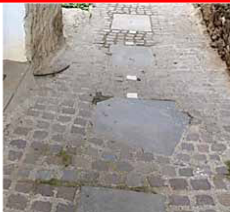
Sconclusionato collage di materiali di recupero allettati con cemento
