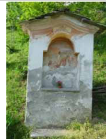
Progressiva perdita dell'apparato pittorico, a causa del degrado che sale dal basso verso l'alto - Varallo, fraz. Morondo
