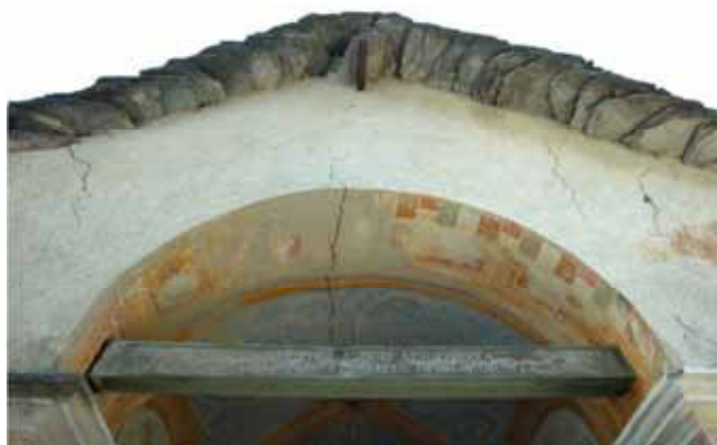
Fessurazione in chiave dell'arco e allontanamento delle due murature di appoggio, attestata dal leggero sfilamento del trave (catena) dal muro a sinistra
