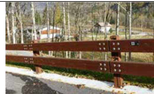
Barriera a due fasce in acciaio corten rivestito sul lato frontale da tavole di legno; il colore della traversa metallica, visibile sul retro, è simile a quello del legno - Riva Valdobbia
