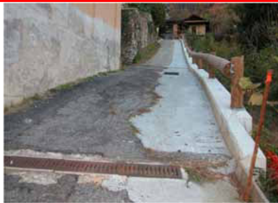
Strada con pavimentazione in asfalto, ripristinata con malta cementizia lungo il nuovo muro in c.a. L'insieme non valorizza il contesto ambientale del luogo
