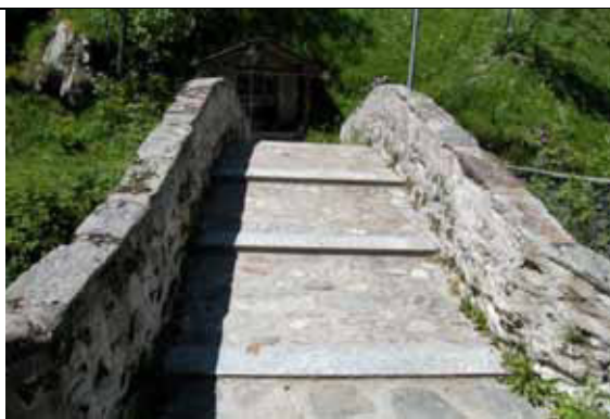
Recente rifacimento della pavimentazione eseguita con pietre annegate in abbondante malta cementizia e scalini costituiti da elementi con superficie liscia e costa rettificata
