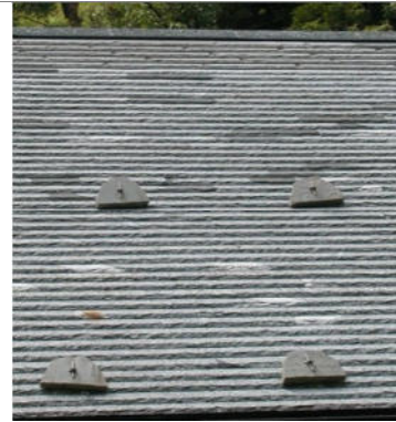
Nuovo tetto con elementi lapidei di formato regolare, spessore e dimensioni costanti, posati a file parallele
