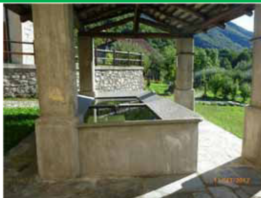
Vocca, fraz. Sassiglioni: vista interna, con ripristino dell'intonaco dei pilastri e dei lati esterni della vasca e pulitura degli elementi lapidei
