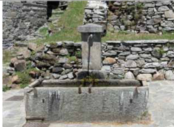
Fontana con tiranti metallici trasversali passanti all'interno della vasca e contrastati sulla faccia esterna delle lastre dei lati lunghi; assemblaggio rinforzato tramite zanche in ferro fissate trasversalmente sul giunto a 45° tra le lastre - Rimasco, fraz. Campo Ragozzi
