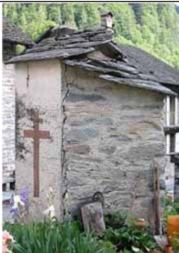
Separazione della muratura rivelata dalla profonda fessura verticale - Rimasco, fraz. Ferrate
