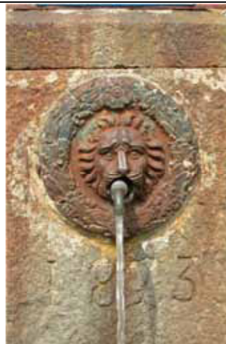
Ossidazione delle parti metalliche con conseguente colatura e macchie di ruggine sulla pietra - Pila
