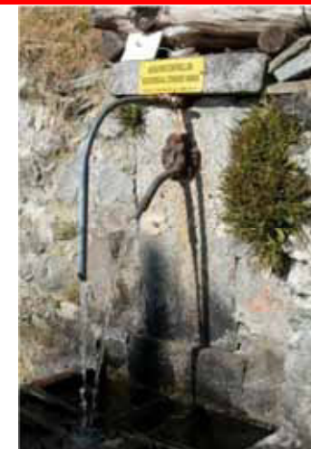
Interventi incongrui e approssimativi, che non valorizzano il manufatto, purtroppo molto frequenti
