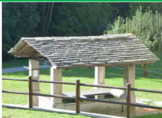
Vocca, fraz. Sassiglioni: vista esterna, con ripristino della muratura e degli intonaci dei pilastri e rifacimento della copertura con manto in piode
