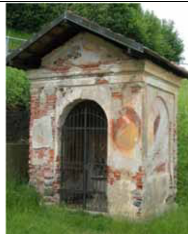
Perdita dei dipinti e degrado generalizzato di tutte le superfici, interne ed esterne e della muratura stessa - Guardabosone
