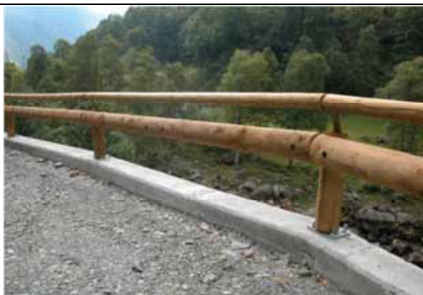
Barriera di sicurezza con traversa e corrimano, in acciaio colore argenteo, mascherato solo sul lato frontale da elementi a mezzo legno - Fobello
