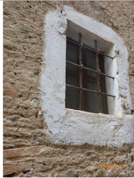
Muro in pietra e mattoni, con rinzafo di malta e cornice della finestra imbiancata con latte di calce
