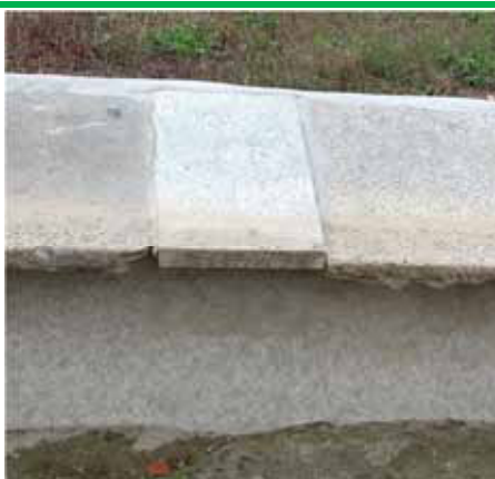
L'intervento ha riguardato anche la lunghissima vasca a canale, provvista di lastre poste in opera inclinate (a scivolo) lungo entrambi i lati. Le lastre sostituite sono diverse sia come tipo lapideo che come lavorazione rispetto a quelle originali
