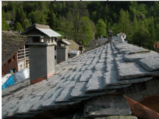
Manto in beole di Luserna di nuova fornitura, grandi dimensioni e formato rettangolare, disposte in filari regolari con sovrapposizione di tre elementi
