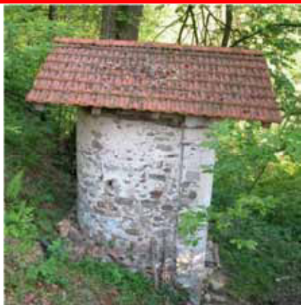
Rifacimento di copertura con eccessivo aumento delle dimensioni dello sporto
