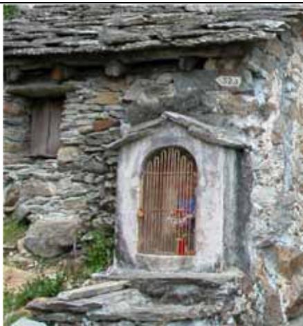
Piccola edicola con nicchia affrescata, aggettante dal muro in pietra di una baita e con tettuccio a capanna costituito da quattro lastre di pietra (piode) - Scopello, alpe Mussoit
