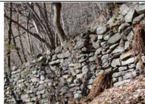
Dislocazione e traslazione in avanti di una porzione di muro, spinto dalle radici di un albero
