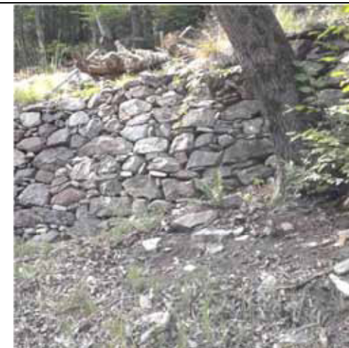
Albero addossato al piede del muro
