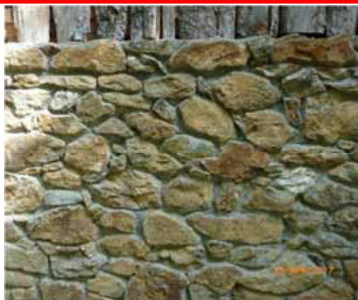
Tutti i giunti sono ripresi in malta cementizia a sottolivello, ma visibile, anche per la colorazione nettamente differente rispetto a quella delle pietre
