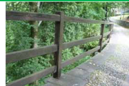
Montanti a sezione quadra e traverse in tavole rifilate e piallate, fissate ai montanti e rinforzate da mensole in metallo. La diversa altezza delle traverse non giova all'aspetto estetico del manufatto - Varallo, Sacro Monte
