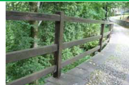
Montanti a sezione quadra e traverse in tavole rifilate e piallate, fissate ai montanti e rinforzate da mensole in metallo. La diversa altezza delle traverse non giova all'aspetto estetico del manufatto - Varallo, Sacro Monte
