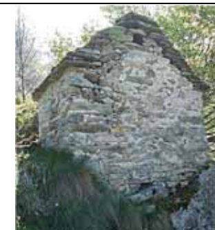
Discontinuità della struttura muraria dovuta a cedimento differenziale della fondazione - Rimasco, fraz. Dorca
