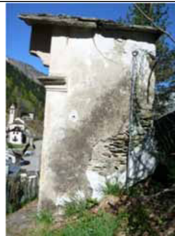
E' visibile sul muro il livello di risalita ed evaporazione dell'acqua, con graduale degrado e patina biologica - Cervatto, Via Crucis (foto 4-2015)
