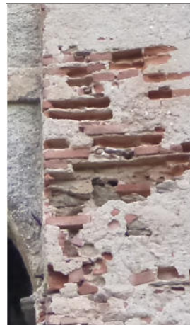
Erosione epolverizzazione dei mattoni - Roasio
