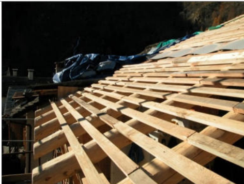
Nuovo tetto: la listellatura è a distanza fissa, dipende dalla pendenza della falda e determina la pendenza e la sovrapposizione delle lastre di beola
