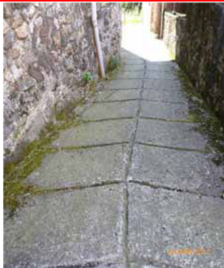
Vicolo con pavimentazione in cemento, che ha coperto quella tradizionale in pietra
