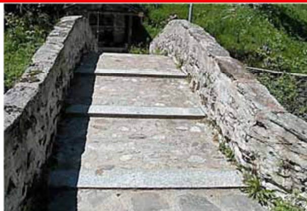
Abuso di malta cementizia per l'allettamento delle pietre e scalini delimitati da elementi lapidei con finitura superficiale troppo regolare e costa rettificata
