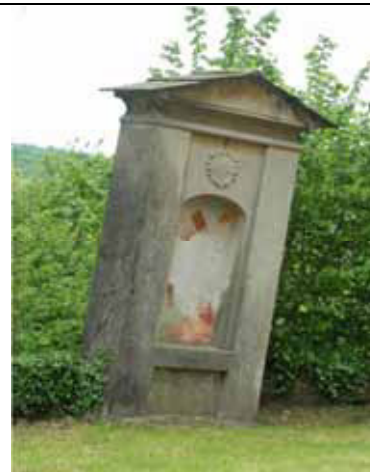
Grave cedimento fondazionale con conseguente sprofondamento solidale del fabbricato - Foresto
