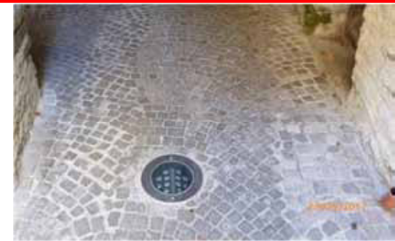
I ripristini del manto in cubetti di porfido (materiale estraneo alla litologia del luogo!), eseguiti a seguito di interrimento impianti, si notano troppo in quanto non riprendono il disegno della pavimentazione precedente e i giunti tra i cubetti sono più larghi e sigillati con troppa malta
