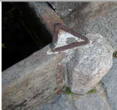
Rinforzo metallico esterno dell'incastro tra le lastre in corrispondenza del pilastro angolare - Piode
