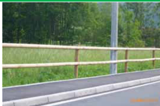
Montanti e traverse in legno di conifera a sezione circolare tornita. Le traverse, particolarmente lunghe in funzione del notevole interasse tra i pali, sono fissate esternamente ad essi - Varallo, località Crosa
