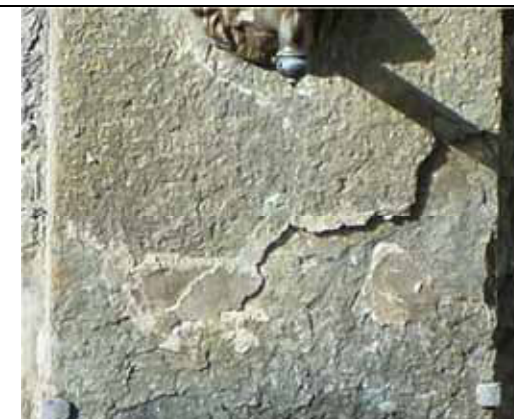
Degrado del materiale lapideo, con esfoliazione e scagliatura che provoca sollevamento, distacco e caduta di strati di pietra sempre più profondi - Balmuccia
