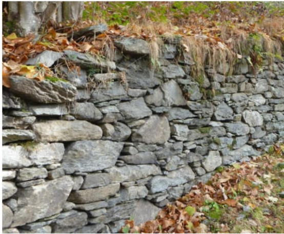
12- Piana Fontana (Mollia): muro a secco in blocchi di gneiss massiccio grezzo
