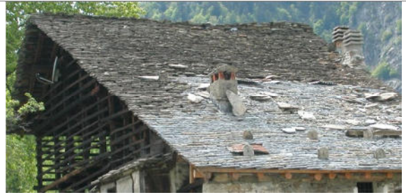
Rimasco: impiego separato in due differenti porzioni della falda, di vecchie piode e di beole nuove senza mescolanza dei due diversi materiali
