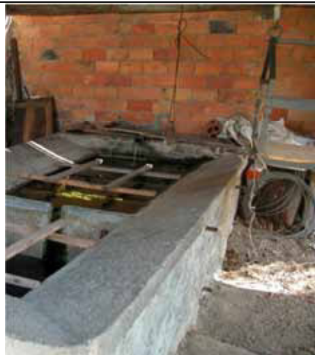
Interventi inappropriati (nuovo tamponamento con muratura di mattoni non intonacati), degrado e impiego del locale per usi impropri
