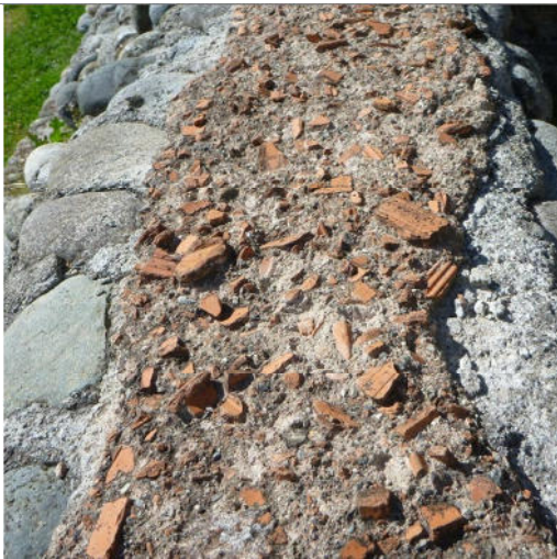
Grossolano tentativo di realizzare una malta addizionata con cocciopesto: alla calce sono stati mescolati frammenti di dimensioni troppo grandi, non macinati, di laterizi moderni.
