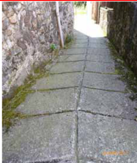
Vicolo con pavimentazione in cemento, che ha coperto quella tradizionale in pietra
