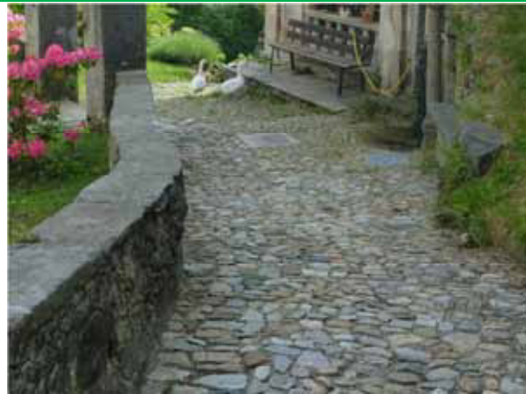
Ripristino di mulattiera a selciato, con impiego di scapoli di pietra locale – Varallo fraz. Morondo
