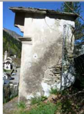
E' visibile sul muro il livello di risalita ed evaporazione dell'acqua, con graduale degrado e patina biologica - Cervatto, Via Crucis (foto 4-2015)
