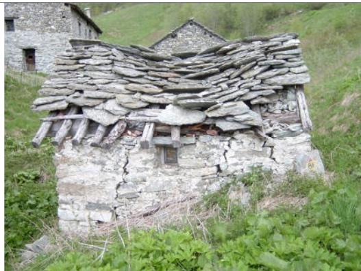
Campertogno, alpe Pian dell'Erba: piccolo fabbricato rurale con grave dissesto statico e copertura in rovina
