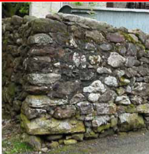
Grossolana risarcitura con malta cementizia su vecchio muro in pietra a secco
