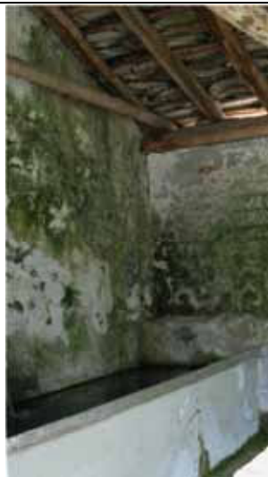
Patina biologica e grave degrado degli intonaci
