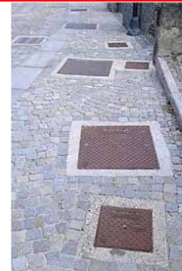
Nuova pavimentazione a cubetti con sequenza disordinata di pozzetti con coperchi metallici contornati da larghe sigillature in malta cementizia
