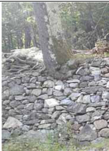
Albero inglobato sopra al muro
