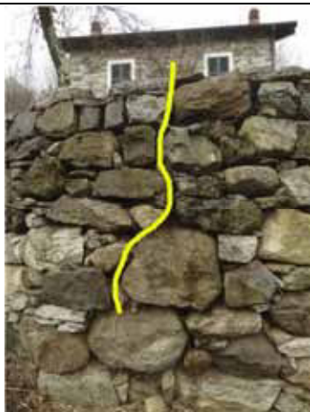
Fessurazione: giunti verticali non sufficientemente sfalsati
