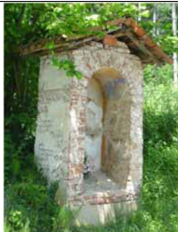
Distacco e caduta quasi totale dell'intonaco e incipiente degrado della muratura in mattoni - Grignasco, fraz. Garodino
