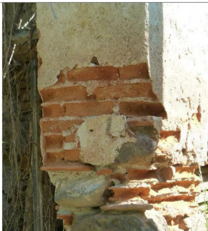
Alveolizzazione ed erosione dei mattoni - Grignasco
