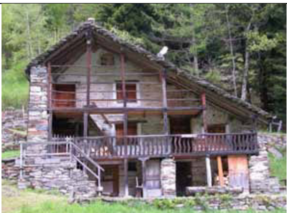
Casa caratterizzata dal colmo del tetto non centrale rispetto alla facciata - loc. Quare
