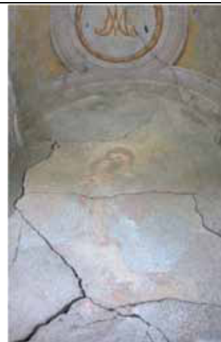
Grave quadro fessurativo che riguarda l'intonaco affrescato e anche la sottostante muratura
