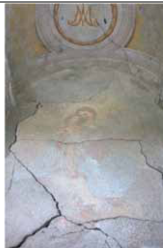
Grave quadro fessurativo che riguarda l'intonaco affrescato e anche la sottostante muratura
