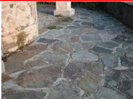
Lastricato con lastre irregolari posate con giunti di malta troppo ampi e con stilatura
