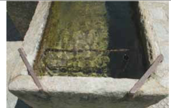
Giunto tra lastre di pietra con taglio a 45°, con rinforzo esterno superiore mediante zanche metalliche e interno alla vasca mediante tiranti bloccati con bullone sulla faccia esterna della lastra (dettaglio della fontana dell'immagine a sinistra) - Rimasco, fraz. Campo Ragozzi
