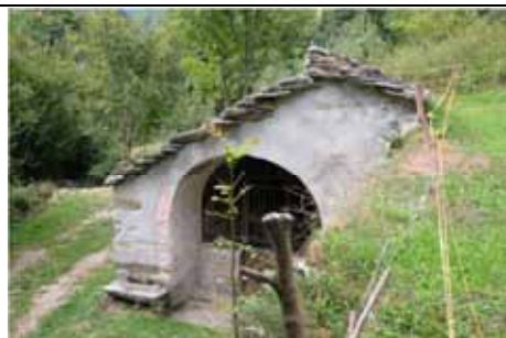
Edificio con un'intera parete contro-terra, con conseguente grave apporto di umidità e danno agli affreschi - Mollia, cappella di San Defendente
