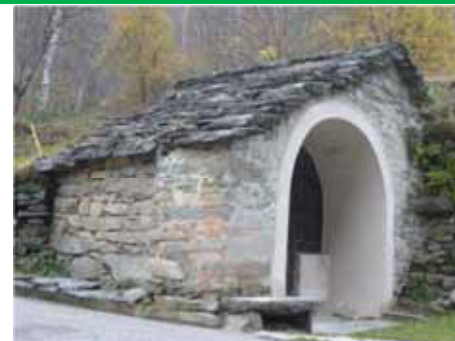
Intervento di risanamento da umidità di risalita mediante realizzazione di intercapedine ventilata lungo la base della parete laterale - Mollia
