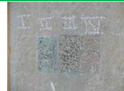
Esecuzione di stratigrafia preliminare agli interventi sulle superfici tinteggiate e/o decorate - Rimasco, fraz. Ferrate
