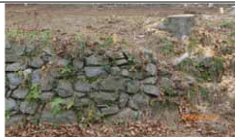
Caduta di pietre e progressivo smontaggio del muro dovuto al passaggio di animali e persone
