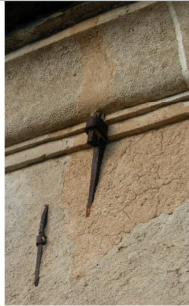
Stesso edificio della foto a sinistra: volonteroso tentativo di realizzare un rappezzo di intonaco imitando la malta originaria: il risultato non è perfetto, ma l'intento è apprezzabile
