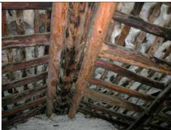
Intradosso di vecchio tetto con tre travi di colmo affiancati - fraz. Rima
