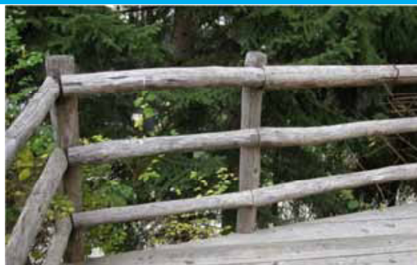
Staccionata con funzione di parapetto anticaduta, con tre file di traverse fissate ai pali. Il legno, non trattato, presenta un aspetto gradevole dato dall'invecchiamento naturale - Riva Valdobbia
