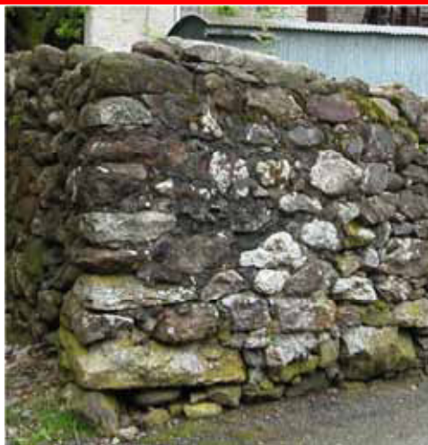
Grossolana risarcitura con malta cementizia su vecchio muro in pietra a secco
