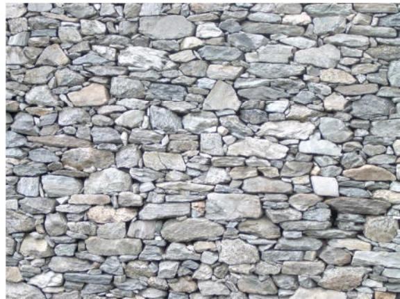
7- Pian dell'Erba (Campertogno): muro realizzato in elementi eterogenei grossolanamente squadrati di gneiss massiccio
