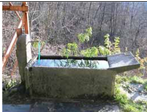
Fissaggio di manufatto prefabbricato in cemento (scivolo) per trasformare la vecchia fontana in pietra in un lavatoio - Canepale (Sabbia)
