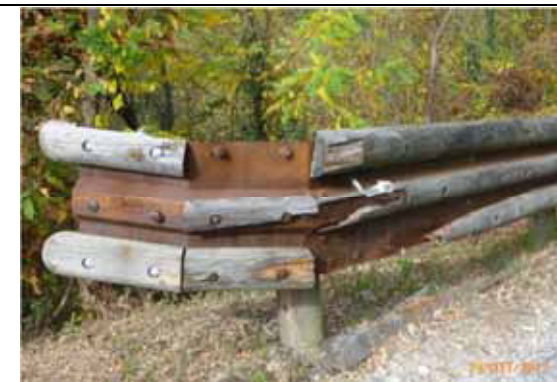
Veloce deperimento del legno e accentuata ossidazione del metallo, favoriti dal ristagno di acqua e umidità sulla superficie di adesione tra i due materiali - strada Traversagna Grignasco-Boca
