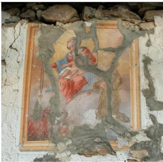
Deplerevoli e grossolane stuccature in cemento, che oltre a essere esteticamente inaccettabili risultano dannose per la conservazioine delle pitture ad affresco
