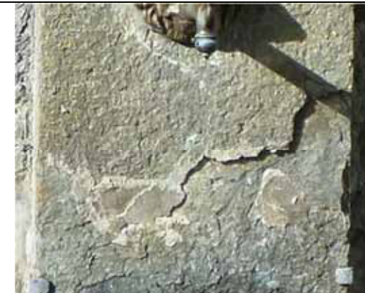
Degrado del materiale lapideo, con esfoliazione e scagliatura che provoca sollevamento, distacco e caduta di strati di pietra sempre più profondi - Balmuccia
