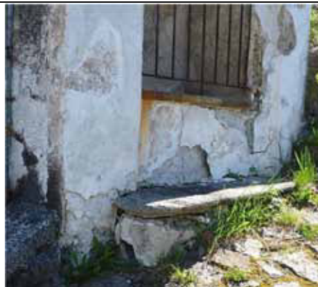
Distacco e caduta dell'intonaco, disgregazione della malta e degrado della muratura, colature di ruggine, distacco dello scalino - Cervatto, Via Crucis (foto 4-2015)
