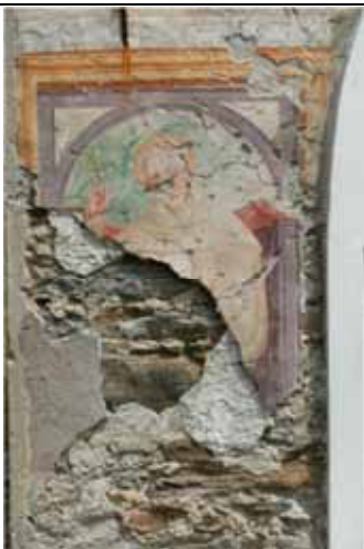
Perdita parziale di pregiato affresco per distacco dal supporto dello strato di intonaco e degli strati di malta sottostanti - Cravagliana, cappella di S. Bernardino
