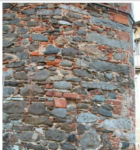
11- Roncole (Postua): muro in pietrame di varia natura litologica e laterizi
