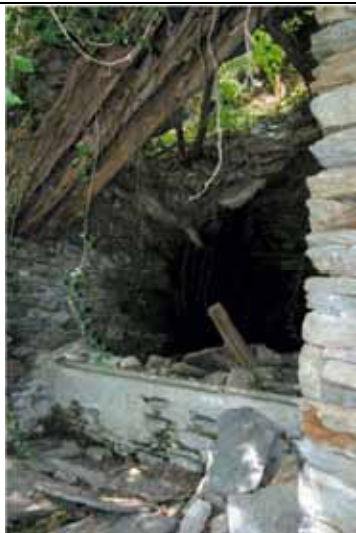
Crollo della copertura e dei muri e danni alla vasca
