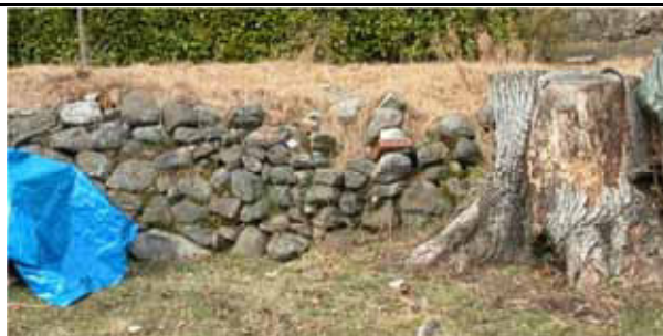
Crollo parziale e incipiente 'smontaggio' del muro, provocato dalla fuoriuscita accidentale di alcune pietre e aggravato dal passaggio di persone e animali
