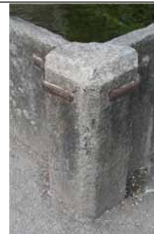
Due zanche in ferro fissate esternamente vincolano le lastre in pietra delle pareti della vasca al pilastro angolare - Scopello
