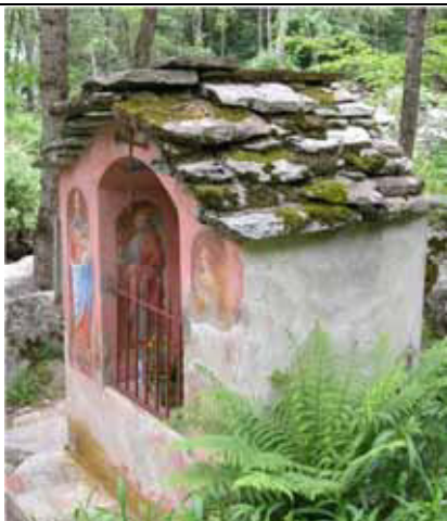
Manto di copertura in piode in pessime condizioni - Rassa, Val Gronda
