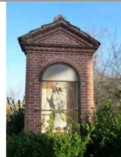
Cappella ottocentesca con muratura e cornici del timpano realizzati in mattoni faccia a vista; copertura attuale in tegole marsigliesi - Maggiore
