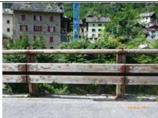
Problemi connessi all'associazione di due materiali differenti, legno e metallo, che, soggetti alle medesime condizioni ambientali, rispondono con un diverso comportamento e differenti reazioni fisiche e chimiche - Campertogno
