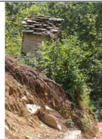
scivolamento del fabbricato a seguito di movimenti del terreno - Rassa, Val Gronda (foto 7-2003)
