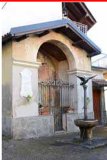
Zoccolatura di tipo inappropriato: rivestimento del muro con lastre di pietra a opus incertum
