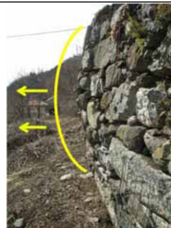
Spanciamento nella parte superiore del muro
