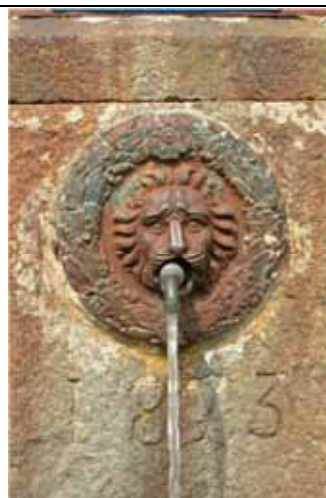
Ossidazione delle parti metalliche con conseguente colatura e macchie di ruggine sulla pietra - Pila
