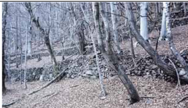
Serie di terrazzamenti agricoli, ora abbandonati, con crescita incontrollata delle piante e progressivo crollo dei muretti in pietra a secco
