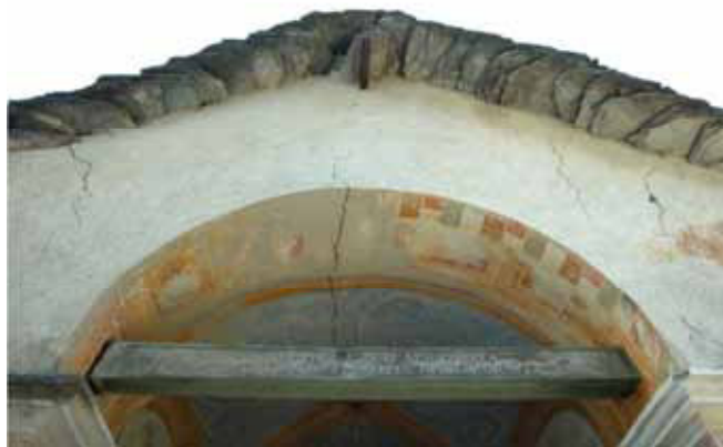
Fessurazione in chiave dell'arco e allontanamento delle due murature di appoggio, attestata dal leggero sfilamento del trave (catena) dal muro a sinistra
