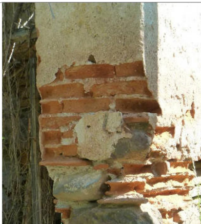
Alveolizzazione ed erosione dei mattoni - Grignasco
