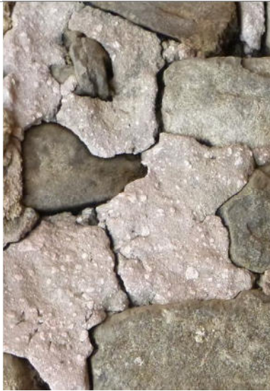
Malta di calce, spenta male, in cui sono visibili i bottaccioli (o calcinaroli), ossia grumi di calce che durante il processo di spegnimento non sono stati sufficientemente idratati.
