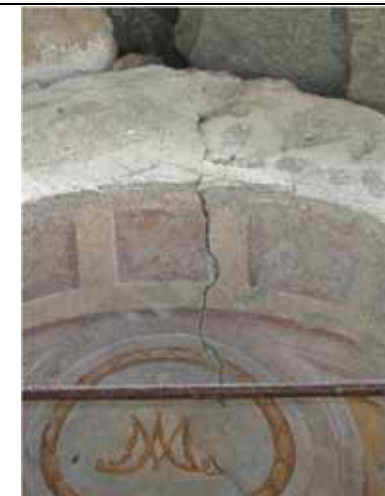
Fessurazione in chiave dell'arco con separazione di due porzioni di muratura che risultano leggermente traslate una rispetto all'altra - Balmuccia, cappelletta loc. Dinelli
