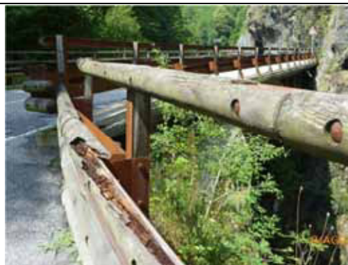
Diverso invecchiamento dei materiali (legno e ferro) con precoce degrado del legno e perdita delle caratteristiche funzionali ed estetiche - Varallo, Ponte della Gula
