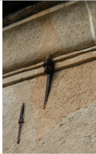
Stesso edificio della foto a sinistra: volonteroso tentativo di realizzare un rappezzo di intonaco imitando la malta originaria: il risultato non è perfetto, ma l'intento è apprezzabile
