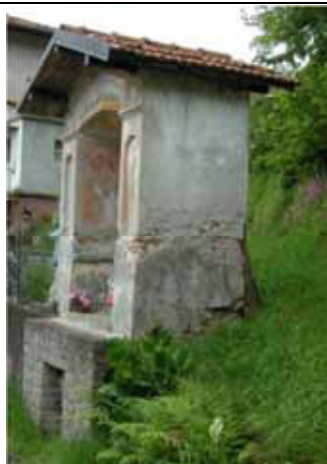
Fascia di erosione dell'intonaco in corrispondenza della quota di evaporazione dell'umidità di risalita - Borgosesia, fraz. Foresto
