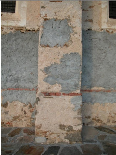
Intonaco originario di colore rosato in malta di calce e sabbia, malamente e sconsideratamente ripreso con rappezi grossolani in malta cementizia dal tipico colore grigio-azzurro
