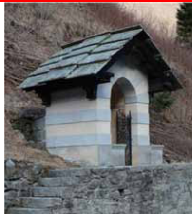
Interventi non conformi alla tecnica e allo stile tradizionali: trattamento pareti, sistema di posa del manto in grandi lastre di pietra
