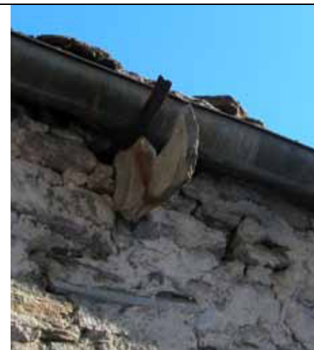
Elemento in pietra sagomato (lastra di gneiss), aggettante dalla facciata, forse utilizzato come supporto per un precedente canale di gronda - fraz. Priami
