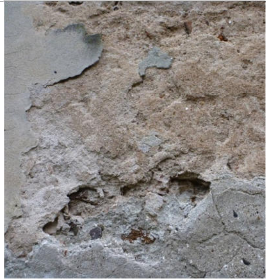
Stratificazioni di intonaci eseguiti con diverso tipo di malta: i più profondi sono a base di calce, quello più superficiale è in malta cementizia
