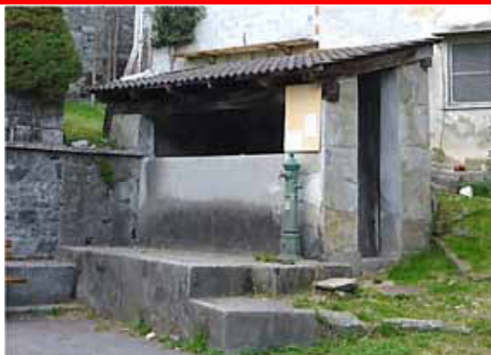
Copertura in tegole cementizie nere, inappropriata in ambiente rurale
