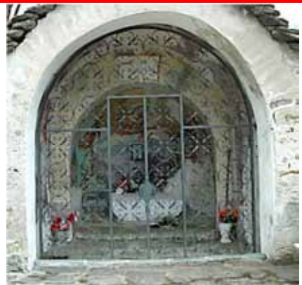
Cancellata artistica in ferro a disegni elaborati che disturbano la visione dell'interno
