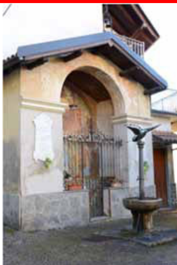
Zoccolatura di tipo inappropriato: rivestimento del muro con lastre di pietra a opus incertum
