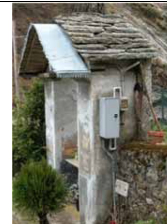
Inappropriata posa di impianti sul muro della cappella, segno di insensibilità verso la tutela dei beni artistici e architettonici - Rassa
